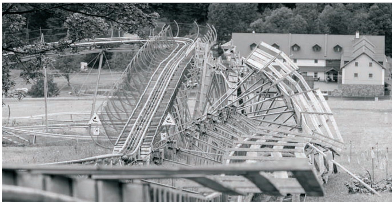
Zničené atrakce na Dolní Moravě.
